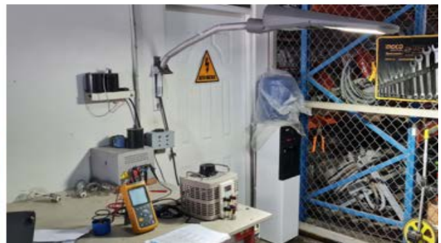
Equipo de pruebas de laboratorio de EDENorte para luminarias
