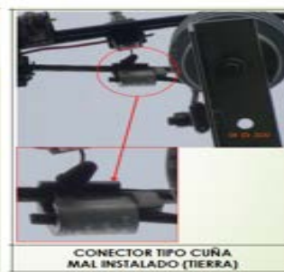
CONECTOR TIPO CUÑA MAL INSTALADO (TIERRA)
