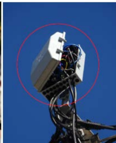
Caja de Derivación mal instalada y abierta
